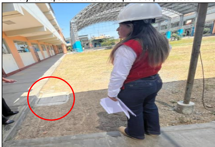
Imagen n.º 15 Caja de inspección de concreto que no se pudo descubrir
