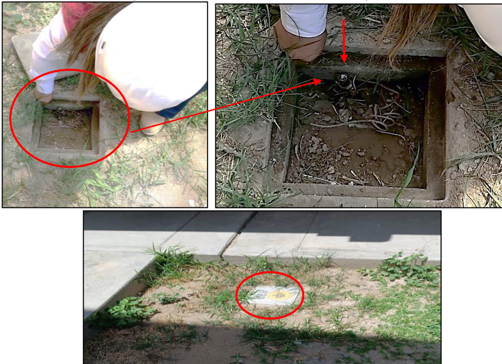
Imagen n.º 13 Pozo puesta a tierra ubicado al lado de la losa deportiva
