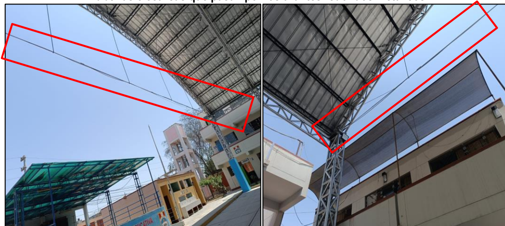
Tuberías eléctricas que pasan por los tirantes redondos metálicos
